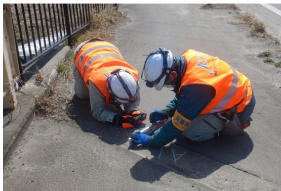
写真 5-2-3 橋梁に発生した隙間の計測
