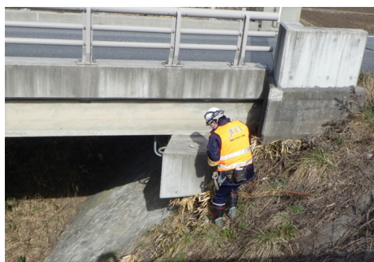
写真 5-2-4 橋脚の被災状況確認
