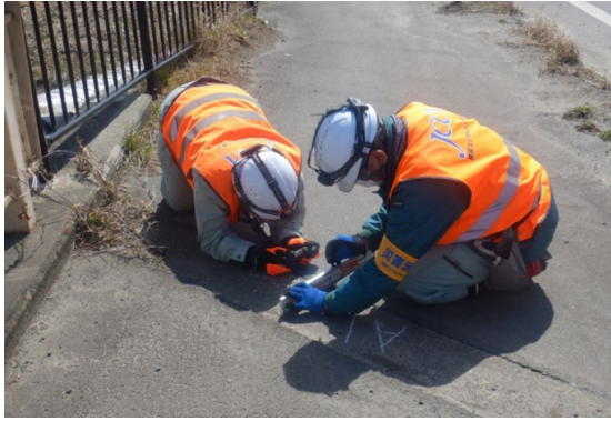
写真 5-2-3 橋梁に発生した隙間の計測
