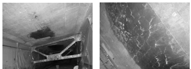
写真-1 床版下面漏水状況
