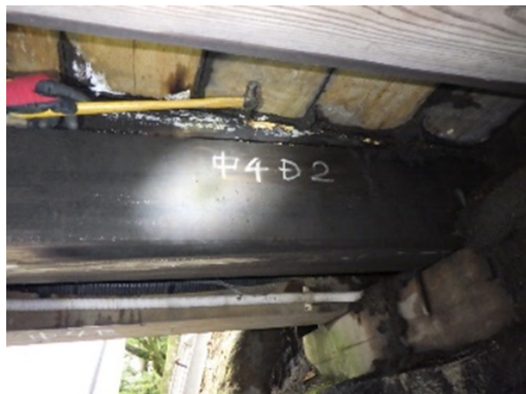
写真-3 桁の腐朽
