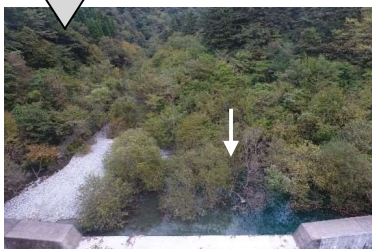
写真-3 E堰堤における堆砂状況写真
