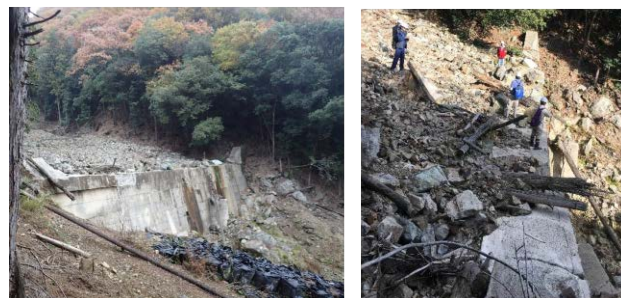
図-5 平成26年の土砂災害によって被災した治山ダム
