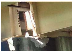
(a) 支承逸脱による桁のずれ
