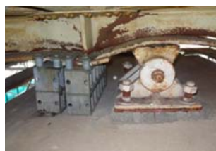
(b) 支点移動による桁座屈
