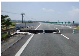
(c) 桁の沈下による路面段差
