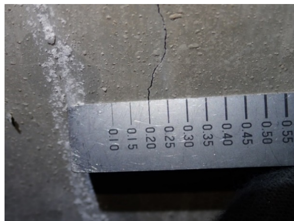
写真-8 ひび割れ⑥のひび割れ幅の状況
