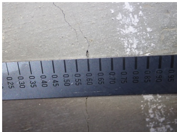
写真-7 自動検出手法で最大ひび割れ幅が確認された箇所（ひび割れ⑥）
