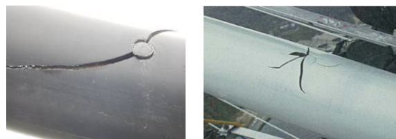
図-3 ケーブルの損傷例
