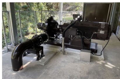
写真-4 ポンプ逆転水車
