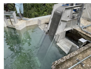
写真-8 ヘッドタンク(改修後)
