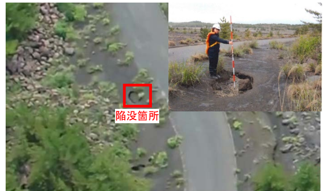
図-3 陥没等の変状（教師データ）事例
