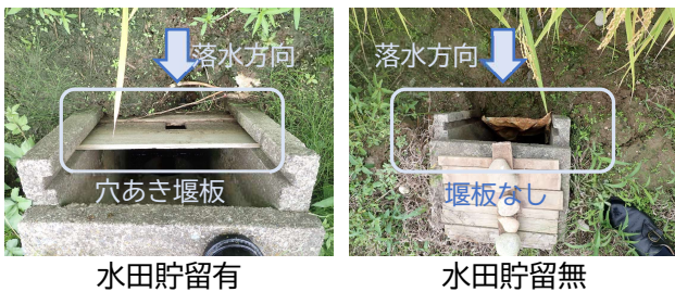
図-2 水田貯留に用いられている堰板および配置
