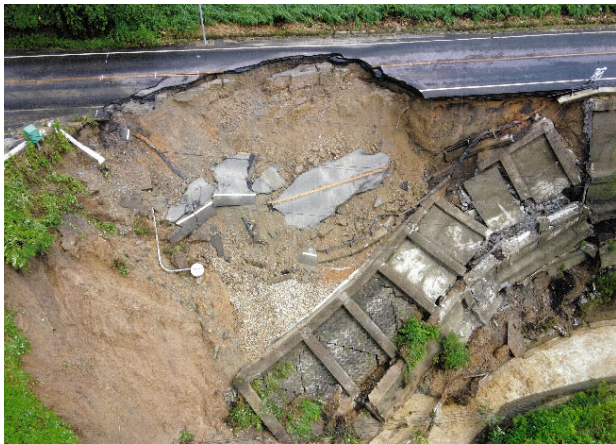
写真-2 被災状況 (山形河川国道事務所提供資料)
