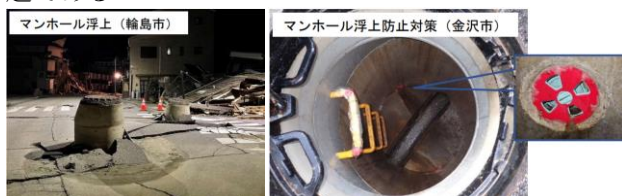
図-1 令和6年能登半島地震マンホールの被害状況 1)
