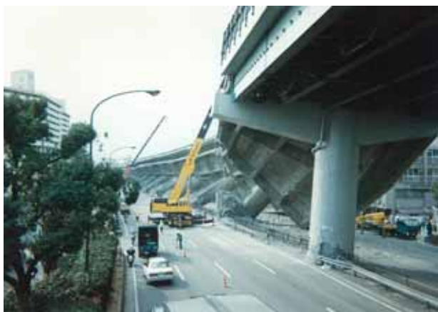
平成 7 年 1 月 阪神・淡路大震災(兵庫県)の被災状況
