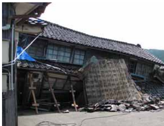
平成 19 年 7 月 新潟県中越沖地震の被災状況 出典：新潟県土木部
