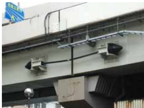
既存の橋を連結して落ちないようにした例
