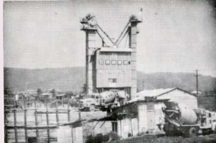
写真19 生コンバッチャープラント
