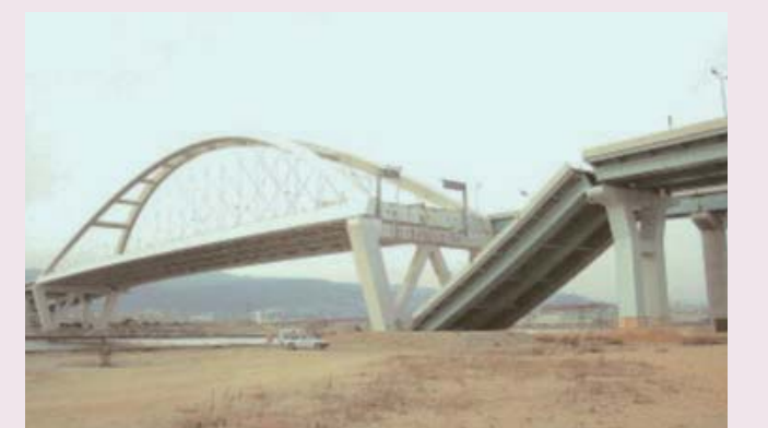
写真4 西宮港大橋の隣接桁の落橋
