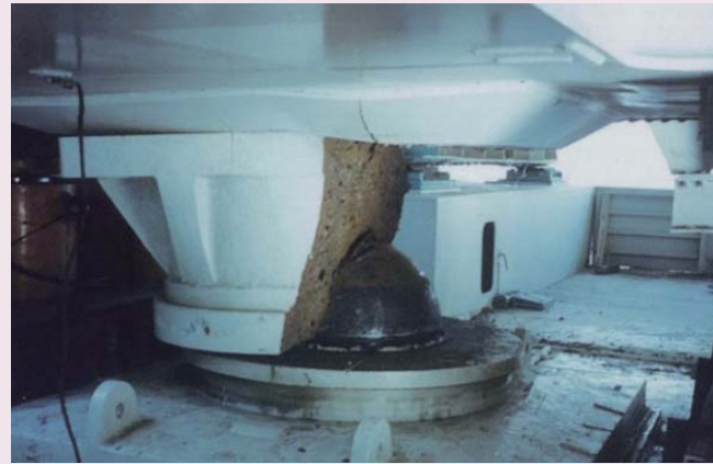
写真5 西宮港大橋の支承破壊
