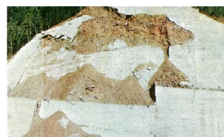
写真 6 小仏地区法面崩壊
