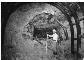
写真10 長平沢断層区間の補助坑
