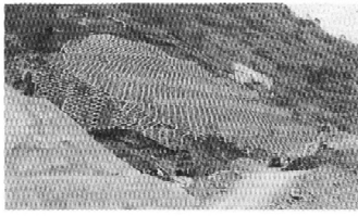
写真 8 岩殿地区法面崩壊
