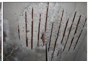
図 15. 床版損傷状況
