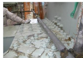
図14. 塗膜割れ状況
