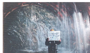
写真 2 補助坑口での湧水状況
