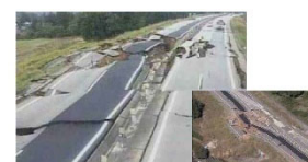
写真 13 中越地震の被害
