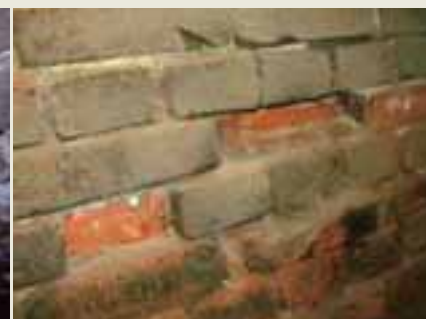
■写真3―レンガの欠損・はく落
