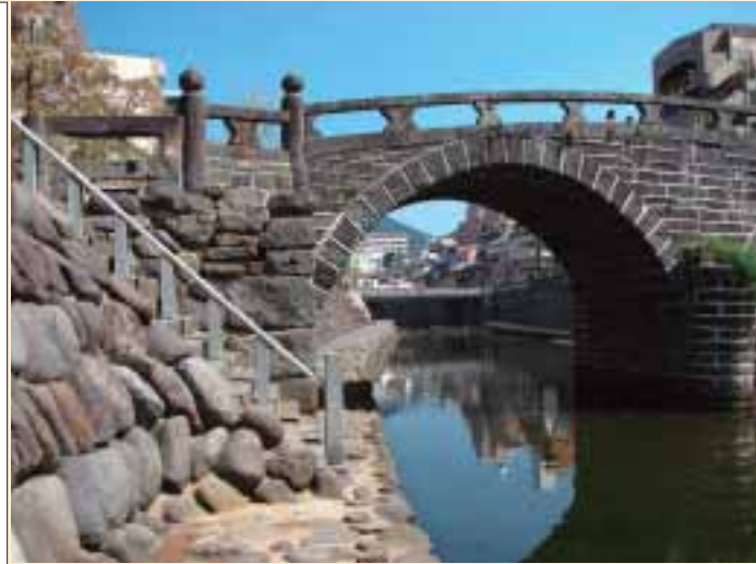
■写真4—水害により大きな被害を受けた右岸下流側。現在はきれいに復元されて目地の漆喰も映える
