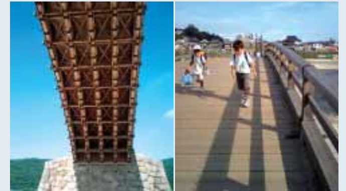
■写真5—錦帯橋の裏面。錦帯橋独自の桁組形式 ■写真6—通学にも利用される橋組形式
