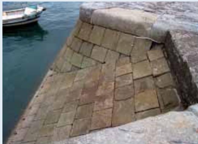
■写真1—埠頭壁の傾斜が緩くなっている浮棧橋跡
