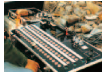
写真7 電気点火の操作盤
