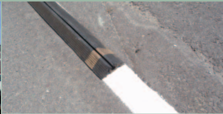
写真4 ゴム材による段差
