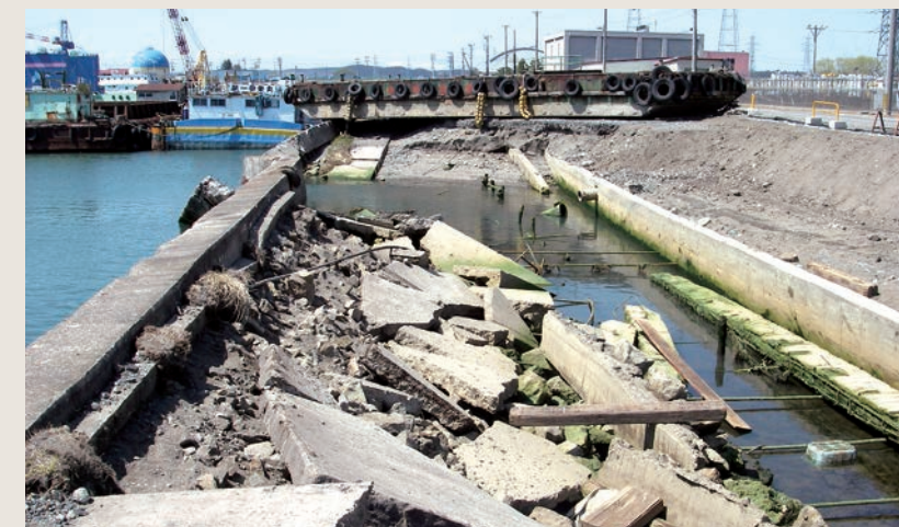
八戸港沼館1号護岸の決壊状況と打ち上げられた台船（被災当時）
