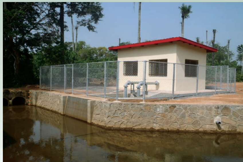
写真3 スワンプの取水ポンプ場
