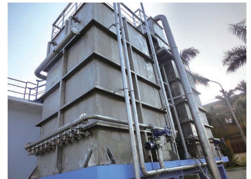
写真4 ビンバオ浄水場で稼動中のU-BCF
