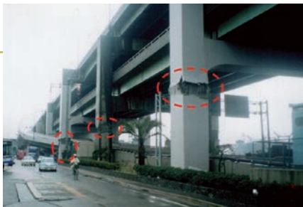
写真1 神戸三宮付近の非埋立地盤では高架道路橋脚の破線で囲んだ部分に揺れの被害が見られた
