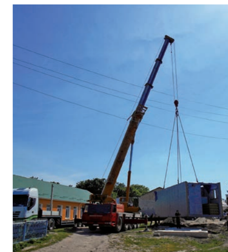
写真2 バイオマスボイラーが設置される小学校
