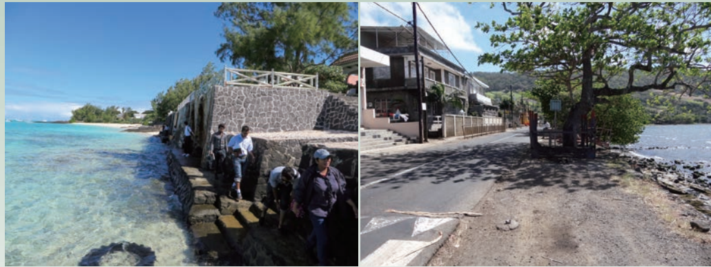
写真3 前浜に構築された護岸と砂浜の消失
