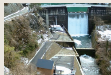
平沢川小水力発電所 (自社事業)
