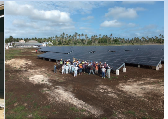
写真8 マイクログリッドシステムの太陽光発電設備
