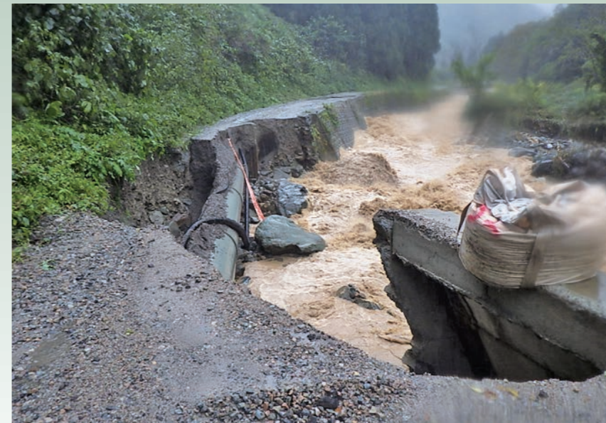
写真3 施工中に発生した河川災害
