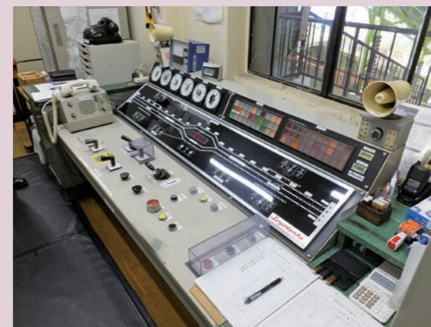
山上の運転室。前方の窓から駅ホームが望める
