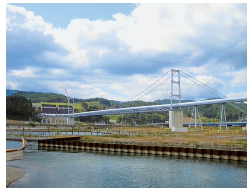
陸前高田市の気仙川右岸の面整備事業地から左岸の事業地へ迅速に残土を運搬する巨大ベルトコンベアー（平成27年10月）
