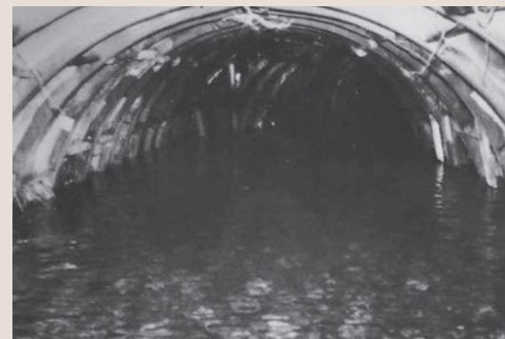
大量出水時のトンネル坑内
