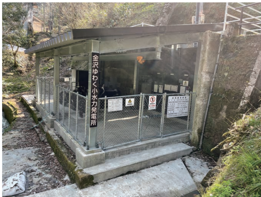
金沢ゆわく小水力発電所
