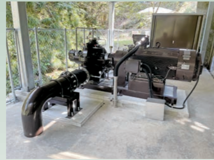
ポンプ逆転水車
