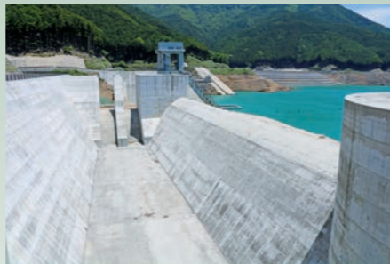
写真3 常用・非常用洪水吐き
