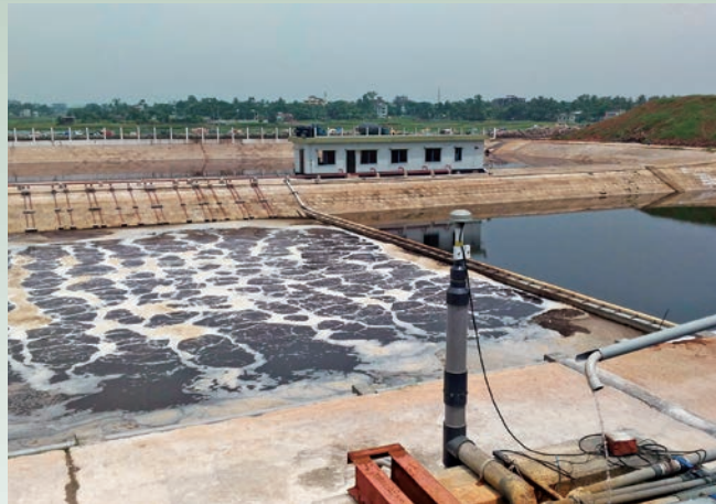
写真4 最終処分場の浸出水処理施設【③処分場改善】
