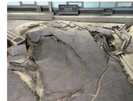
破壊された道路
