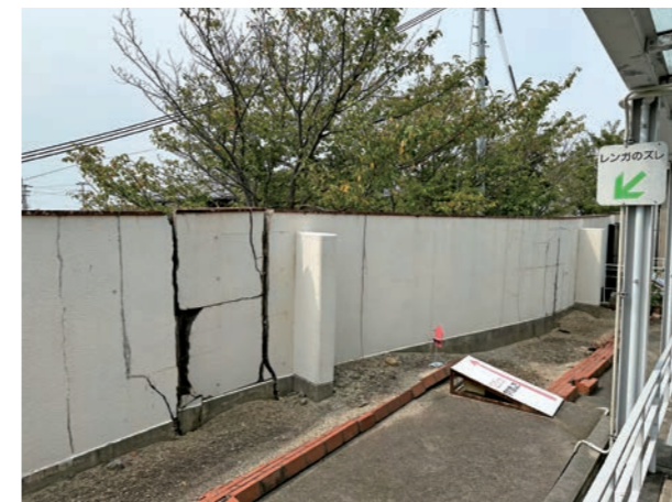
断層によって割れた塀と花壇のずれ
