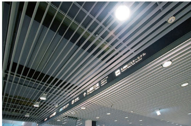
写真2 ルーバー（羽板）式天井
